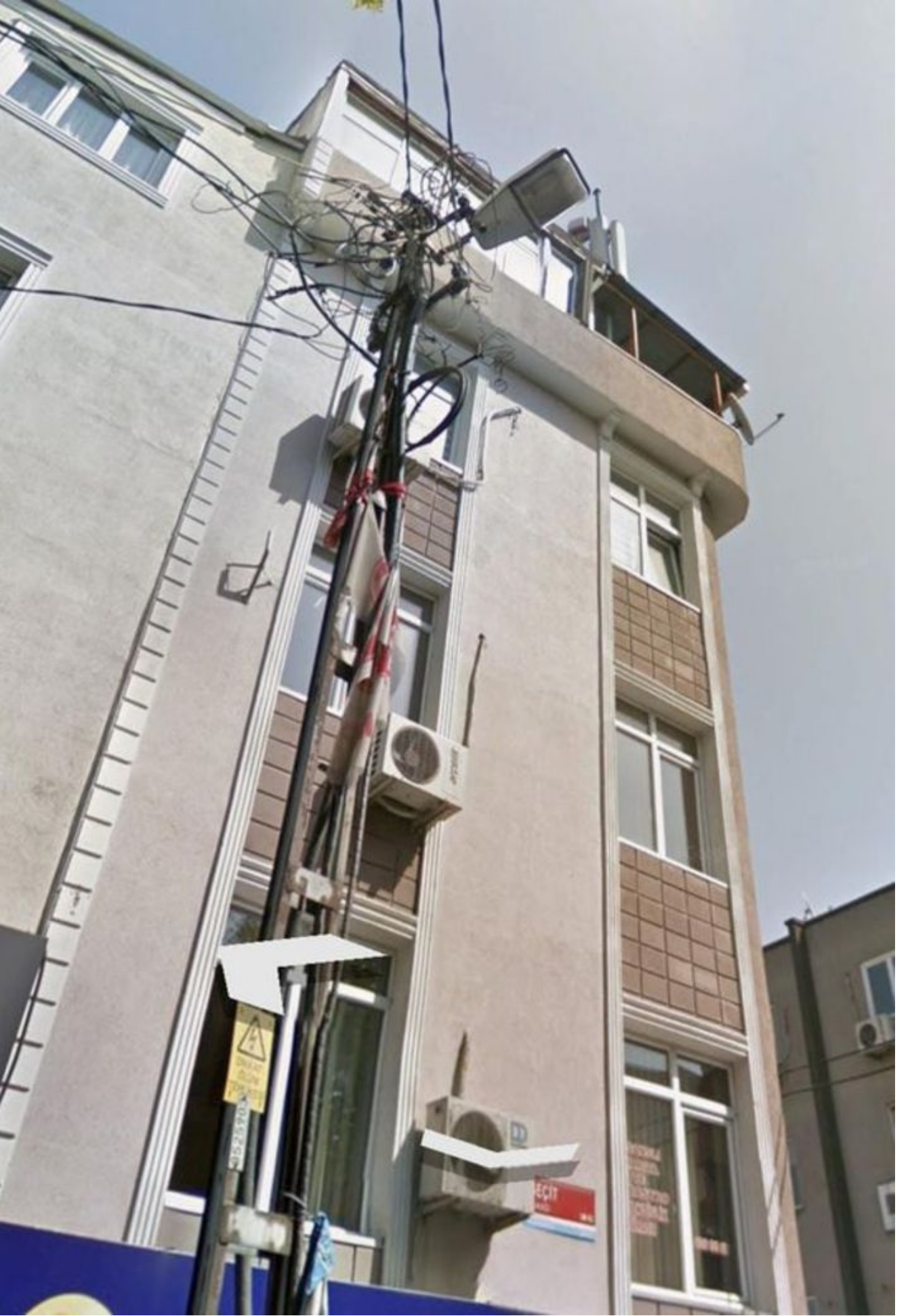
Küçükçekmece'de yıkılan binanın fotoğrafı
